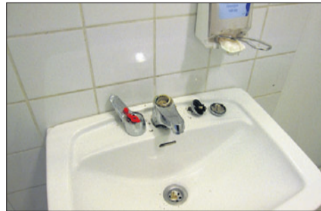
Illvilligt nedmonterade toaletter och lavoarer i Gymnasiet Grankulla samskola i mitten av september.
