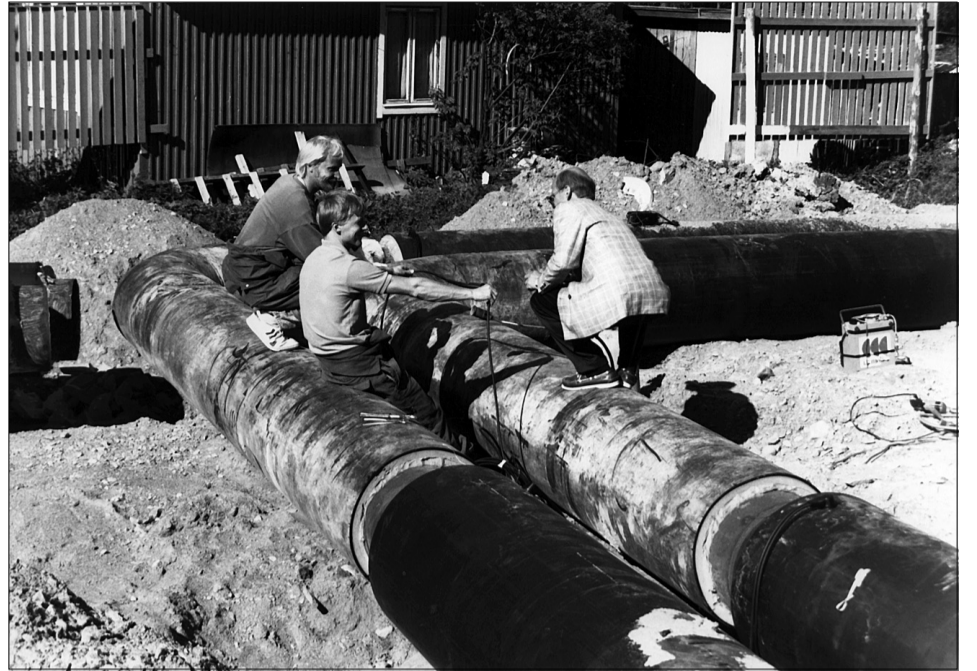
Pääjohtoputkia liitettiin yhteen ennen kuin ne peitettiin maa-aineksella. Huvudrören sammanfogades innan de täcktes in.
